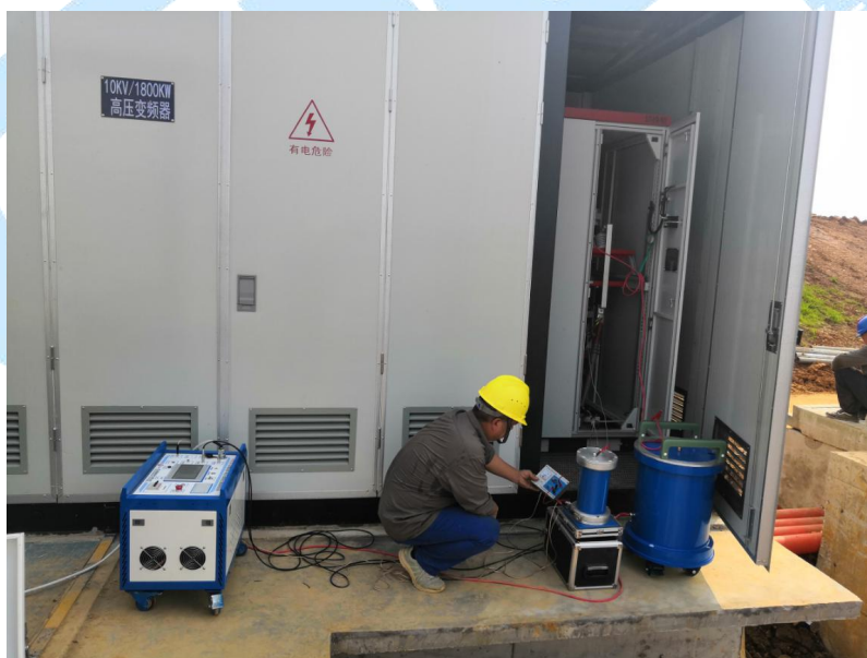
图 6-1(a) 现场测试图（仅供参考）
