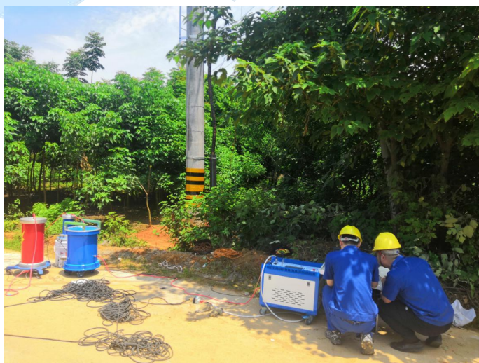
图 6-2(a) 现场测试图（仅供参考）
